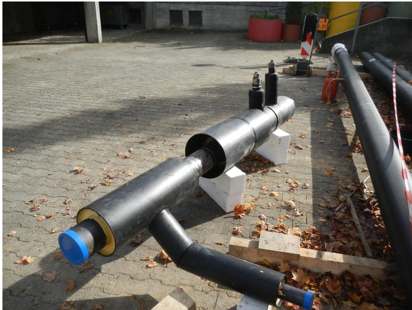
Bild 5: Fernwärmearmatur (Kugelhahn, Entlüfter, Abgang)
