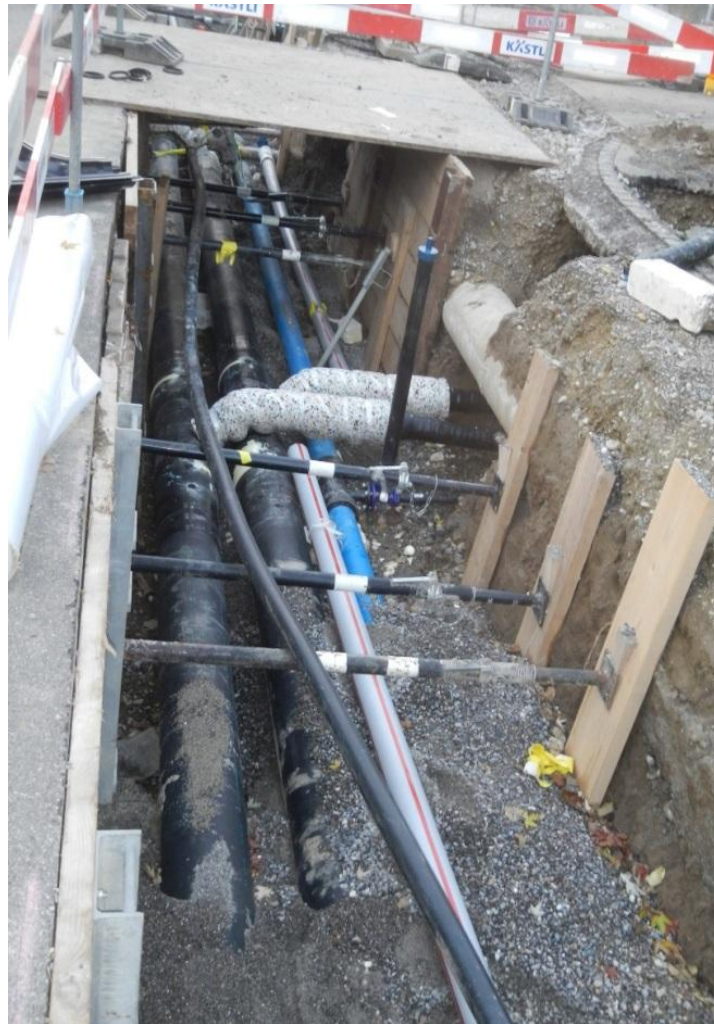
Bild 3: Abgang für Hausanschluss mit Wasserleitung
