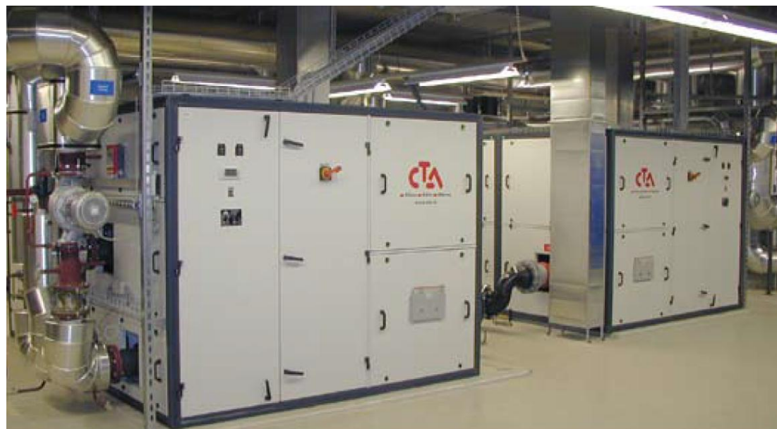
ZWPA Zentrale Wärmepumpenanlage Schlossmatte
